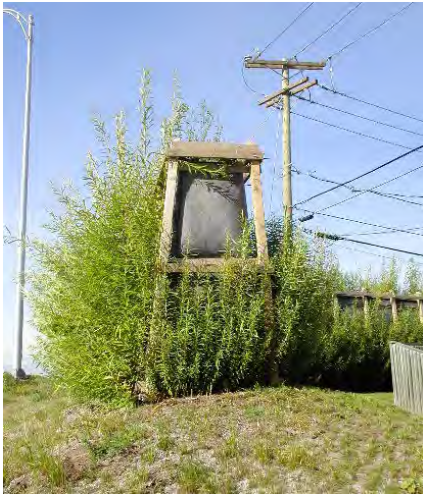
Mur-écran végétalisé installé dans un secteur à proximité de la route 117, à Laval, au nord du boulevard Dagenais, afin de protéger les bâtiments localisés sur la rue de l'Ombrette.
